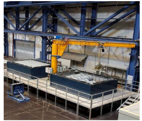
Bild 3: GNS-Verpackungs- und Verfüllstation
